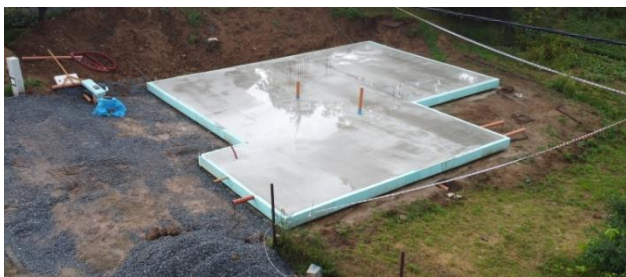
základová deska beton C20/25, vyztužení ocelovou rohoží R8 150*150mm, podklad z drceného kameniva
